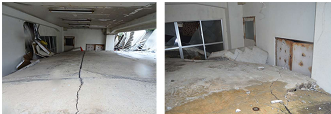
図 2.3 建築物の沈下に伴う床版の持ち上がり 7)
