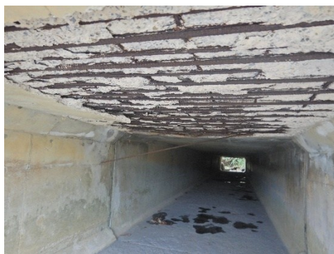
図-7 塩害により被害を受けた構造物
