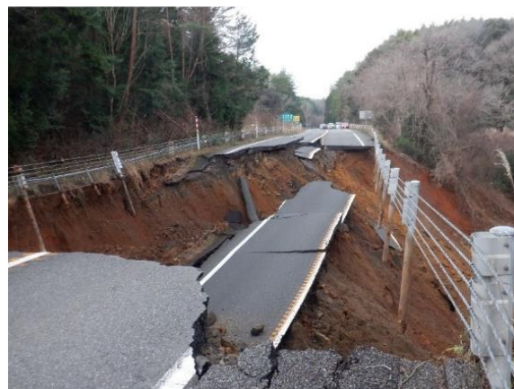
出典：令和6年能登半島地震に対する北陸地方整備局の対応について（第40報）（北陸地方整備局）
