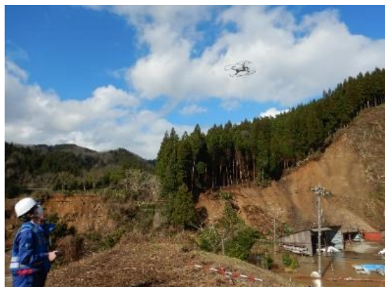
出典: 能登半島地震でのドローン活用について(国土交通省) 図 24 ドローンを活用した土砂崩落調査
