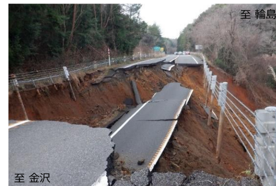
令和6年能登半島地震による被災状況 (のと里山海道：徳田大津IC～横田IC間)
