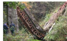
老朽化した橋梁の被害
