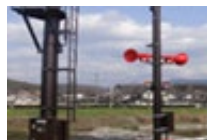
放流警報システム (テレメーター)
