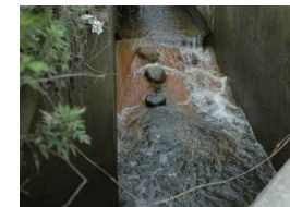
改良された魚道（片斜面粗石付魚道）
