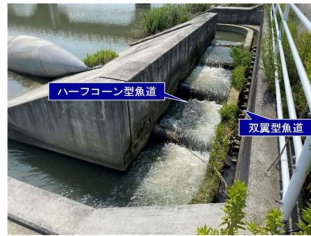
伏樋堰に設置された魚道
