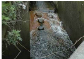
改良された魚道（片斜面粗石付魚道）
