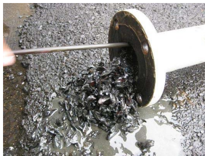
配管の目詰まり
