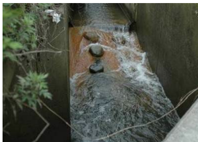
改良された魚道（片斜面粗石付魚道）
