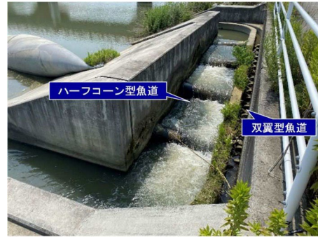
堰樋堰に設置された魚道
