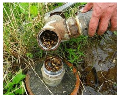
給水栓の目詰まり
