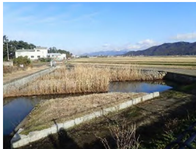
ナガエツルノゲイトウが侵入した循環かんがい施設の浄化池で、水田内に入るおそれがあることから、送水が止められた事例
