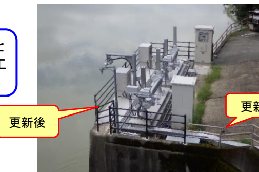
図-24.4-3 整備前後の安全設備
