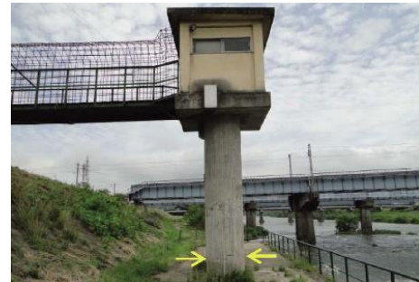
操作室柱基部のひび割れ
