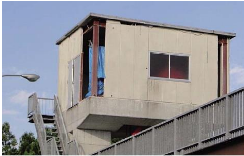
操作室外壁パネルの脱落
