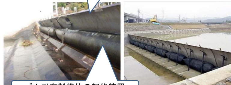
ゴム引布製袋体の起伏装置
