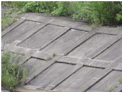
護岸ブロックのひび割れ
