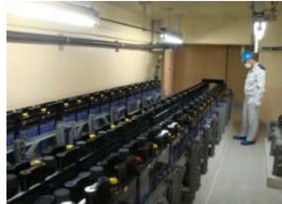
125V蓄電池室の例
