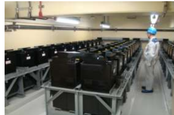
250V蓄電池室の例
