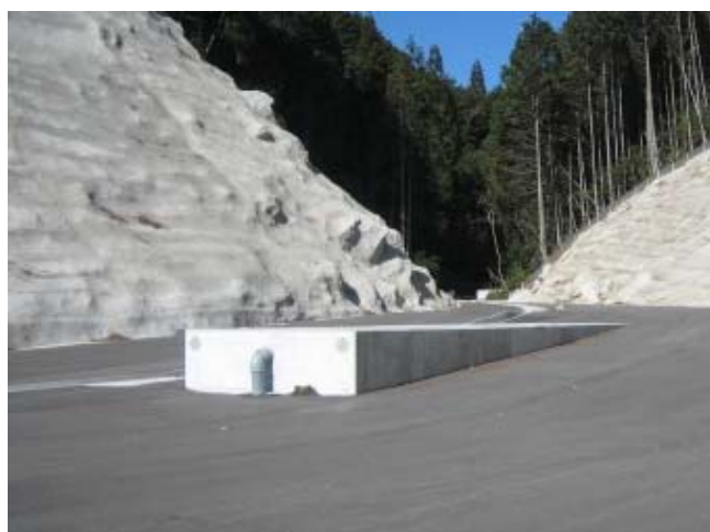
図５－１８ 場内の池（調整池）を地下構造とした例 （中央のコンクリート部が地下水槽になっている）
